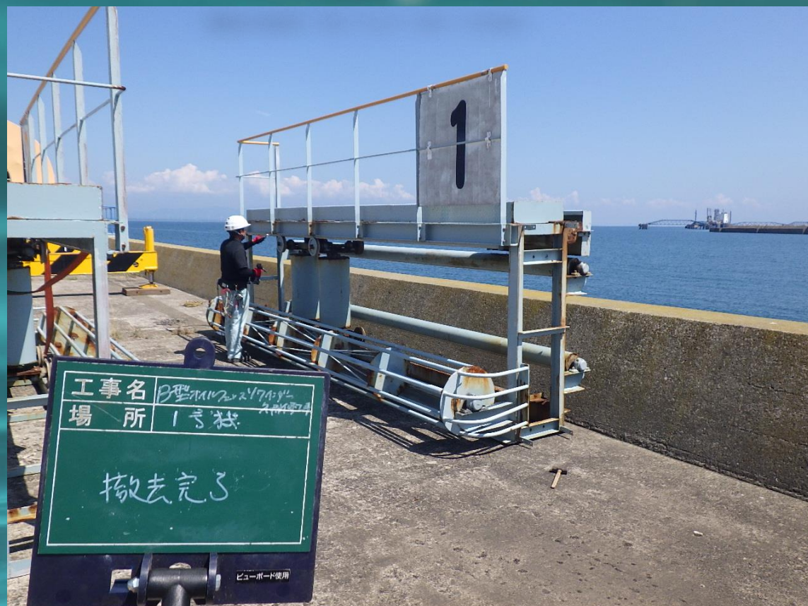
整列機 オーバーホール前
